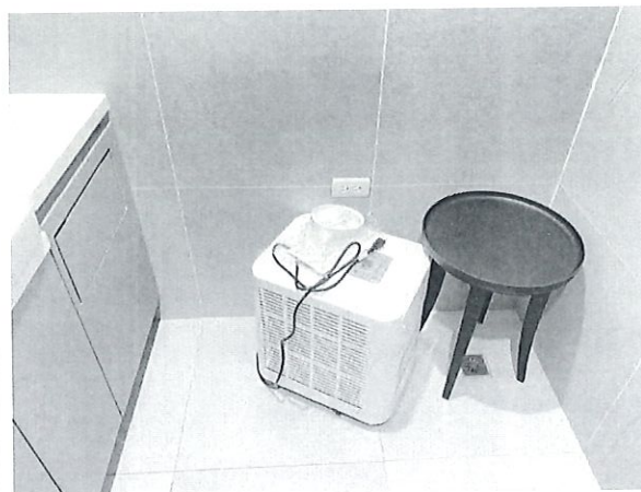
移動式空調擺放實際狀況
